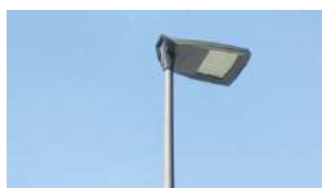
lamp voor het parkeerterrein
